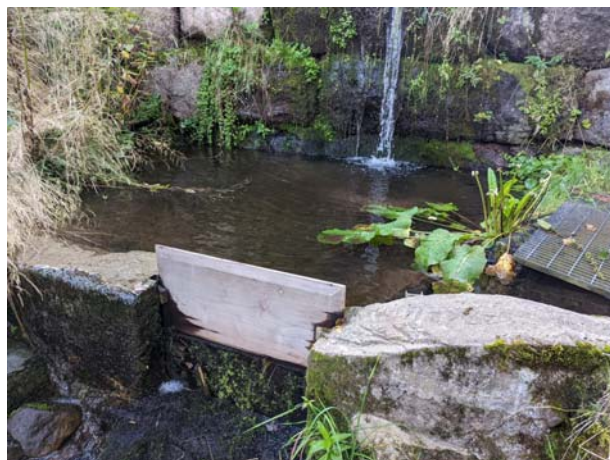
Fig. 5. Ostruzione dell'opera di rilascio DMV. Foto archivio Appa.
